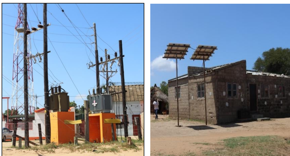
Figura 16 e 17: Sistema de fornecimento de energia eléctrica na AIP
